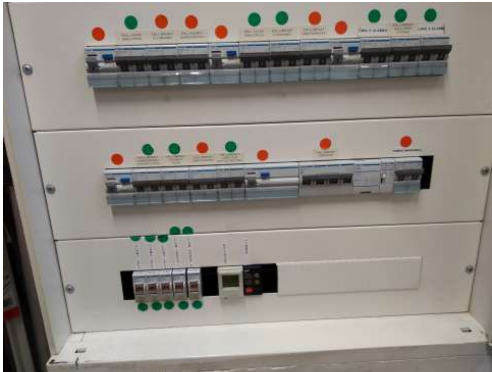
Fig. 11 Espai disponible al quadre de connexió per a la instal·lació de l'interruptor general FV.
