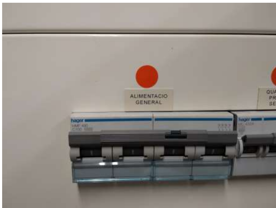
Fig. 10 Interruptor de connexió a la xarxa general de l'edifici
