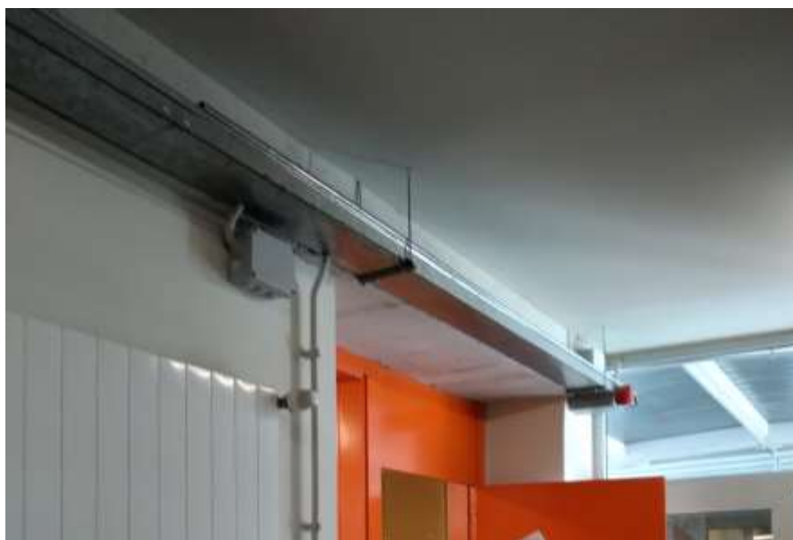
Fig. 7 Safata per al pas de cablejat
