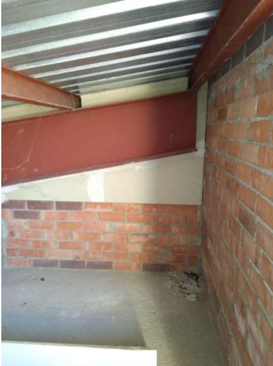
Fig. 5 Futura zona d'inversors
