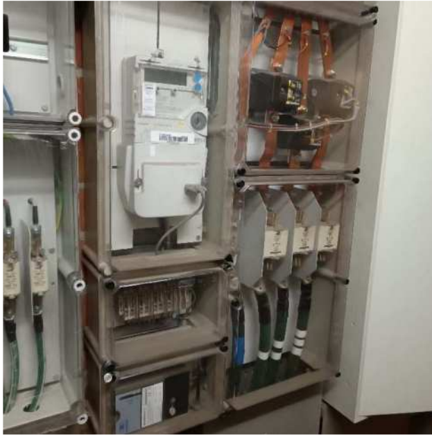
Imatge 1 - Quadre General de proteccions i equips de mesura
