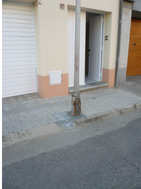
Foto 2. Estat de molts suports de la instal·lació de l'Avinguda Castellet
