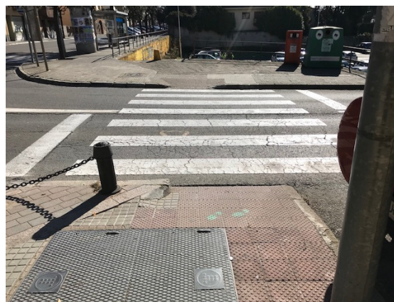
Gual descentrat del pas de vianants en la Carretera Mont-rodon
