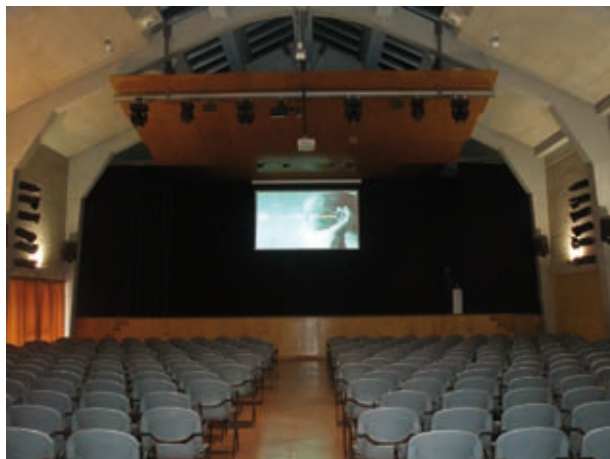
Noves instal·lacions d'audiovisuals del Centre Cultural Costa i Font.
