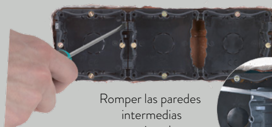
Instalación Simon 82 Centralizaciones
